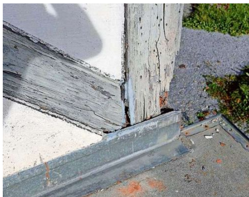
Durch die in den 70er-Jahren angebaute Terrasse drang Wasser ins historische Fachwerk ein. Die beschädigten Teile sollen ersetzt werden.
